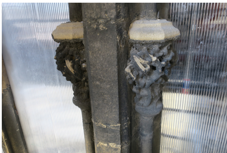
Détail des chapiteaux présentant d'importantes croûtes noires avant le nettoyage - © DRAC Grand Est
